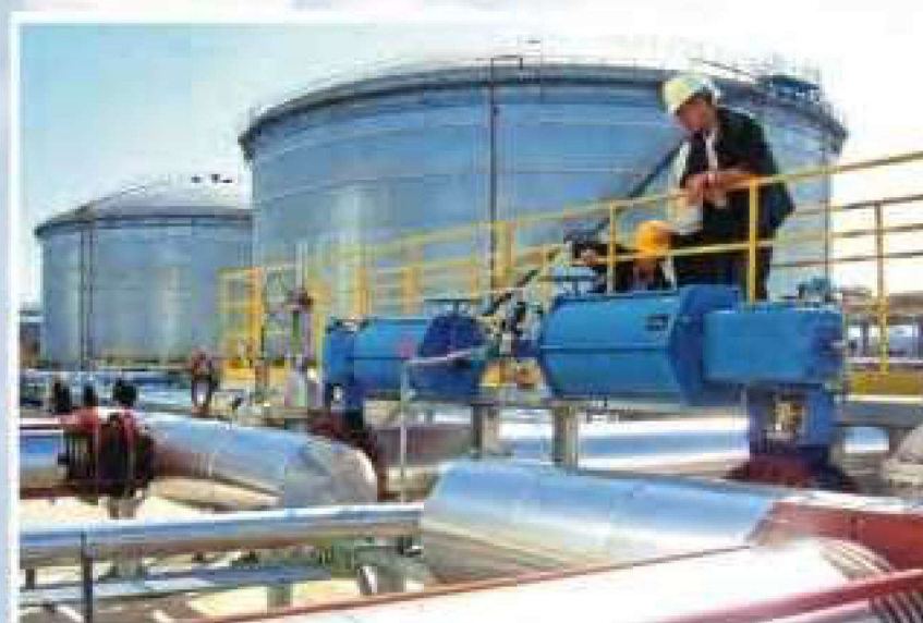
高性能蝶阀使用在石化装置
